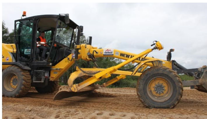
Operator równiarki podczas pracy z zastosowaniem systemu Trimble GCS 900 3D. System 3D precyzyjnie lokalizuje pozycję lemiesza maszyny na projekcie oraz automatycznie dostosowuje wysokość i nachylenie poprzeczne lemiesza
